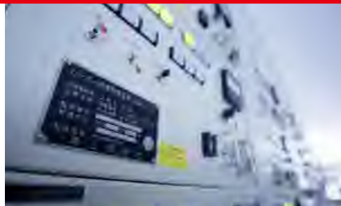
海上保安庁の船舶通航管理システム制御室
