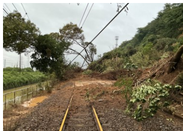
内房線 姉ヶ崎～長浦 土砂流入
