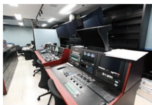
Sub-control rooms (SUB)
