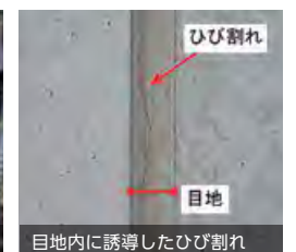
目地内に誘導したひび割れ
