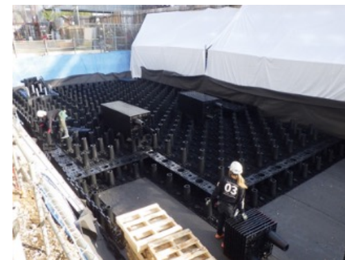
地下に設置された雨水貯留浸透槽
