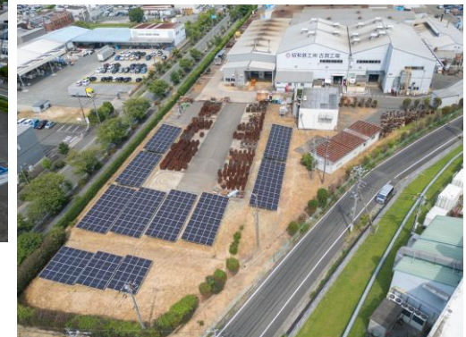
古賀工場 最大出力100kW
