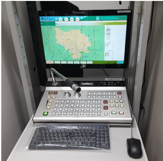
市役所内 操作卓
