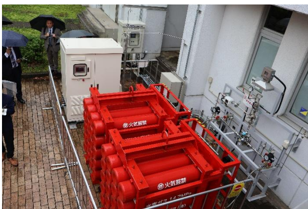
旭公園体育館の燃料電池
