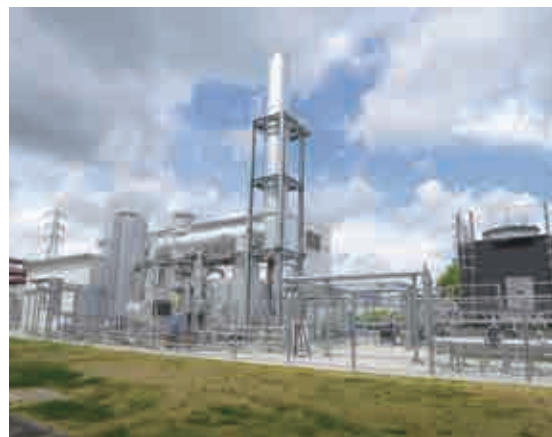
ハウス食品静岡工場に設置したガスコージェネレーションシステム
