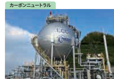
関西電力(株)舞鶴発電所内のCO 2 輸送システム(陸上設備) 世界最先端の設備を設計から建設まで一貫対応
