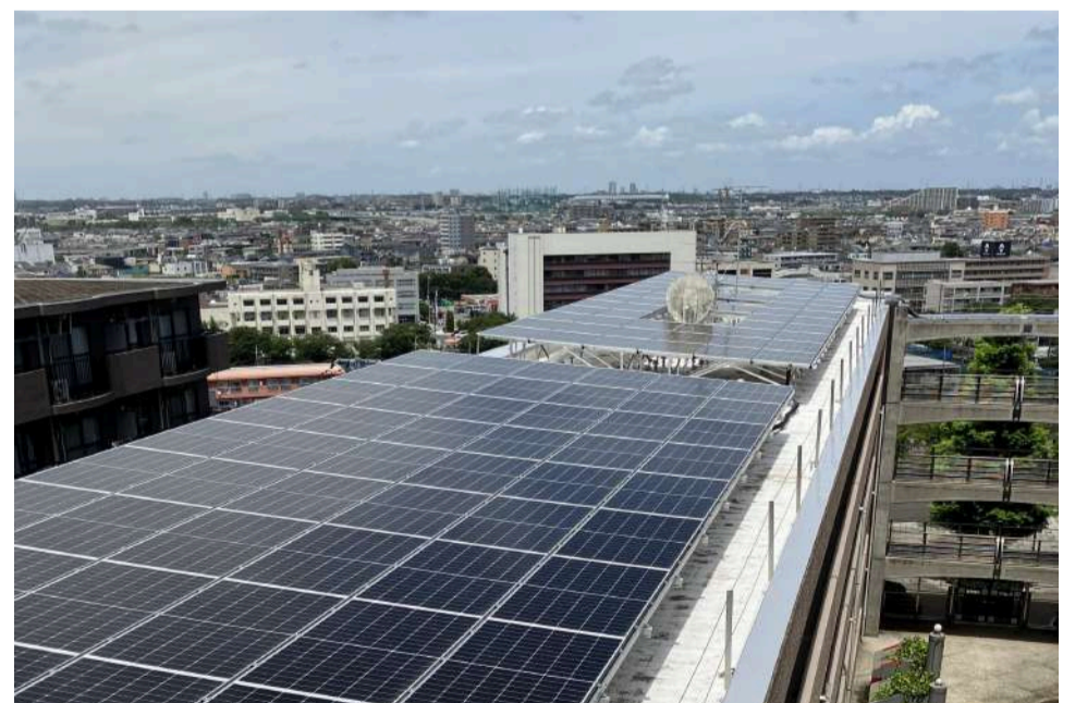
太陽光パネル
