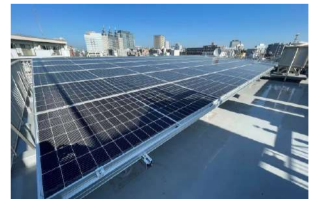
屋上に設置した太陽光パネル
