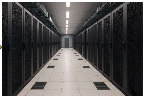
データセンター内
