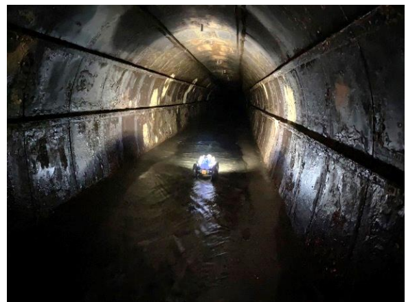
自動走行中の点検用 AGV
