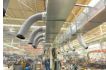
東京工場7号機、9号機の空調設備
