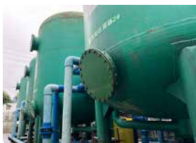
最終濾過タンク
