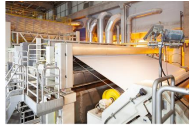
配管・ダクト
