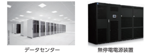
データセンター
