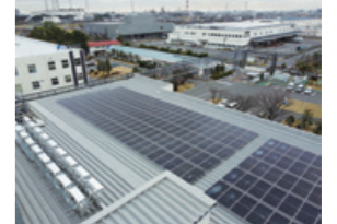
三重工場 太陽光発電設備
