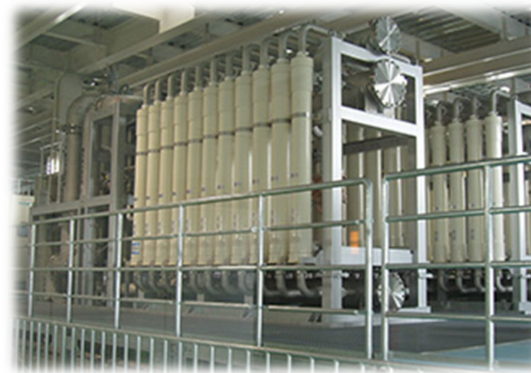
浄水施設(膜処理設備)の全景
