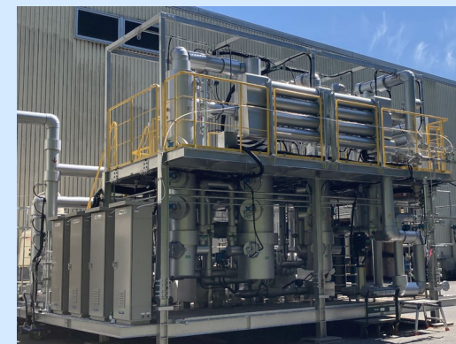
CO 2 の分離回収を行う実証装置
