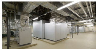
給排水衛生設備
