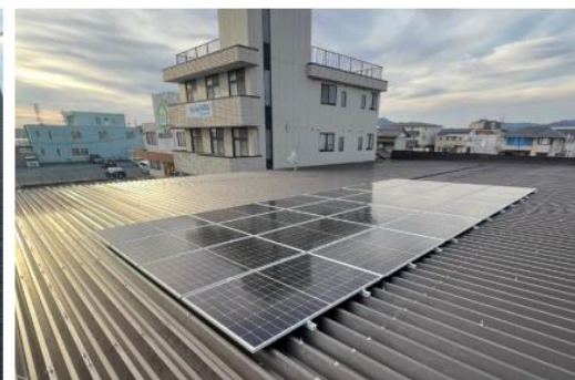
【設置した太陽光パネル】
