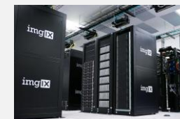
データセンター
