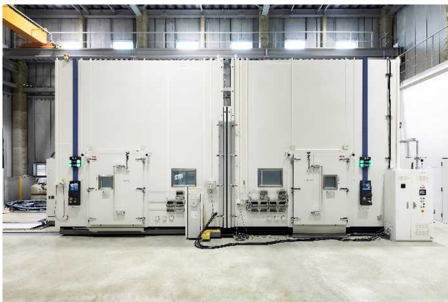
恒温(恒湿)室 建材用試験室
