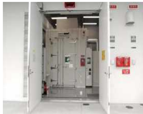
充放電試験用の恒温恒湿室
