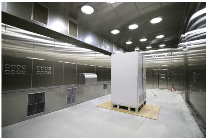
大型恒温恒湿室
