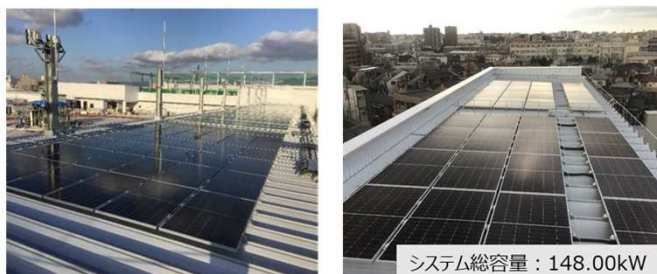
「三井ショッピングパーク ららぽーと福岡」太陽光発電設備（一部）
