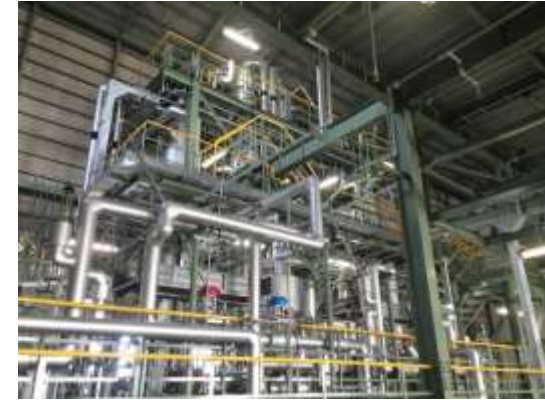
新潟工場のメタノールパイロット設備
