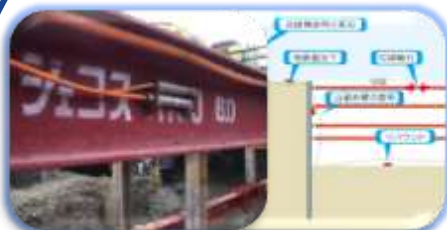
山留壁の品質管理向上 傾斜計・ひずみ計
