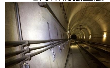
不感知対策工事
