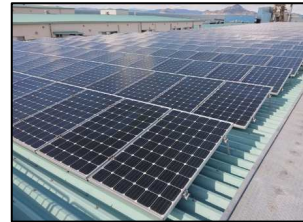
工場の太陽光発電システム
