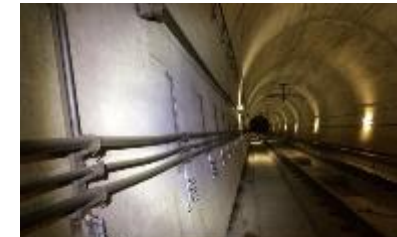
不感知対策工事
