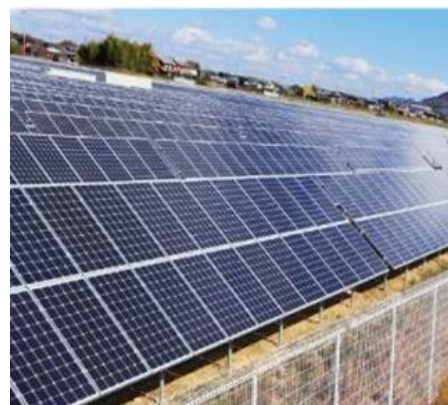
自社太陽光発電所
