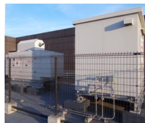
〈非常用発電機〉
