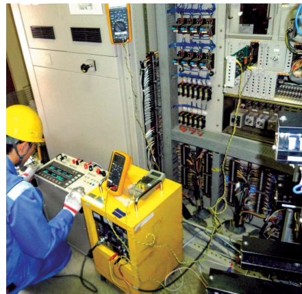
水力発電設備AVR点検
