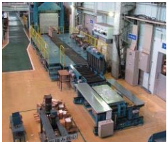
変圧器生産ライン
