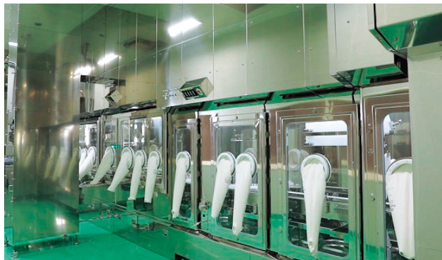
アイソレーター（足利工場「新注射剤棟建設工事」） （写真提供：シミックCMO株式会社）
