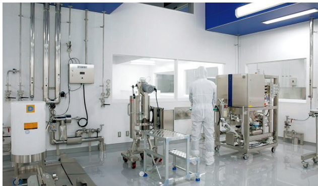
精製室（静岡工場「バイオプロセス開発棟建設工事」） （写真提供：シミックJSRバイオロジクス（株）／シミックCMO（株））
