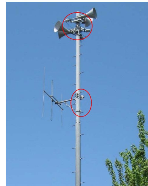
(施工例) 防災無線用金物
