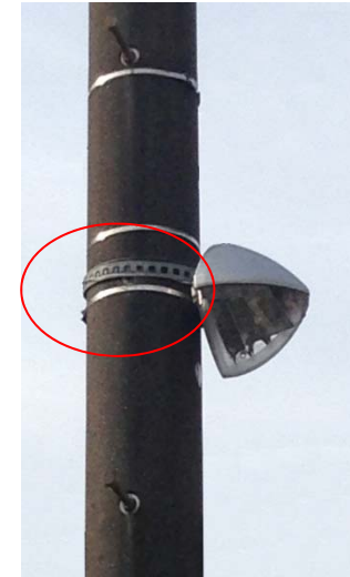
(施工例) 当社製自在バンドで 施工したLED防犯灯
