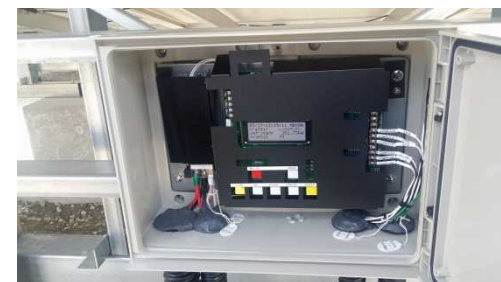
コントロールボックス
