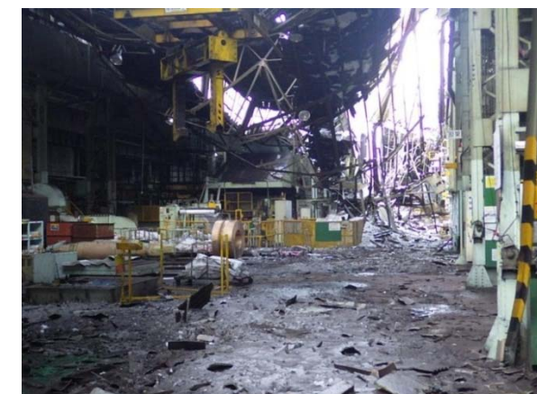
被害直後の状況
