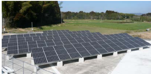
小型ソーラー発電施設
