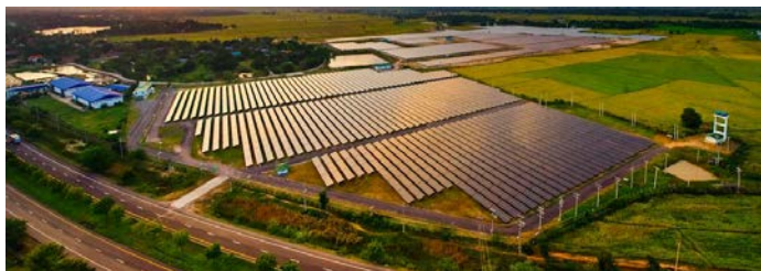
当社製太陽電池を使用したタイの大規模ソーラー発電所
