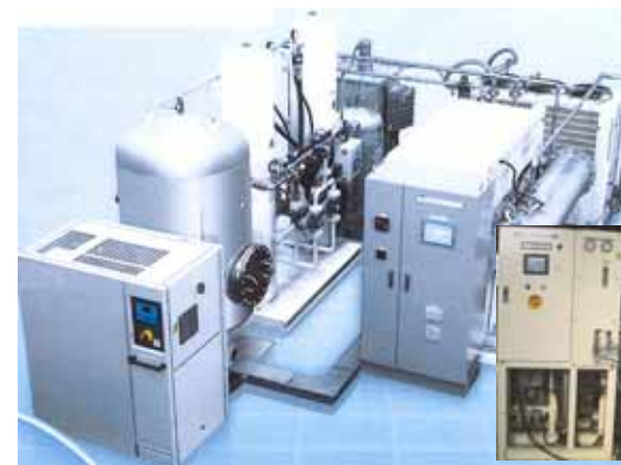
【バラスト水処理装置・P S Aガス分離装置】
