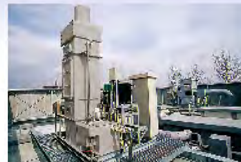
排ガス処理装置
